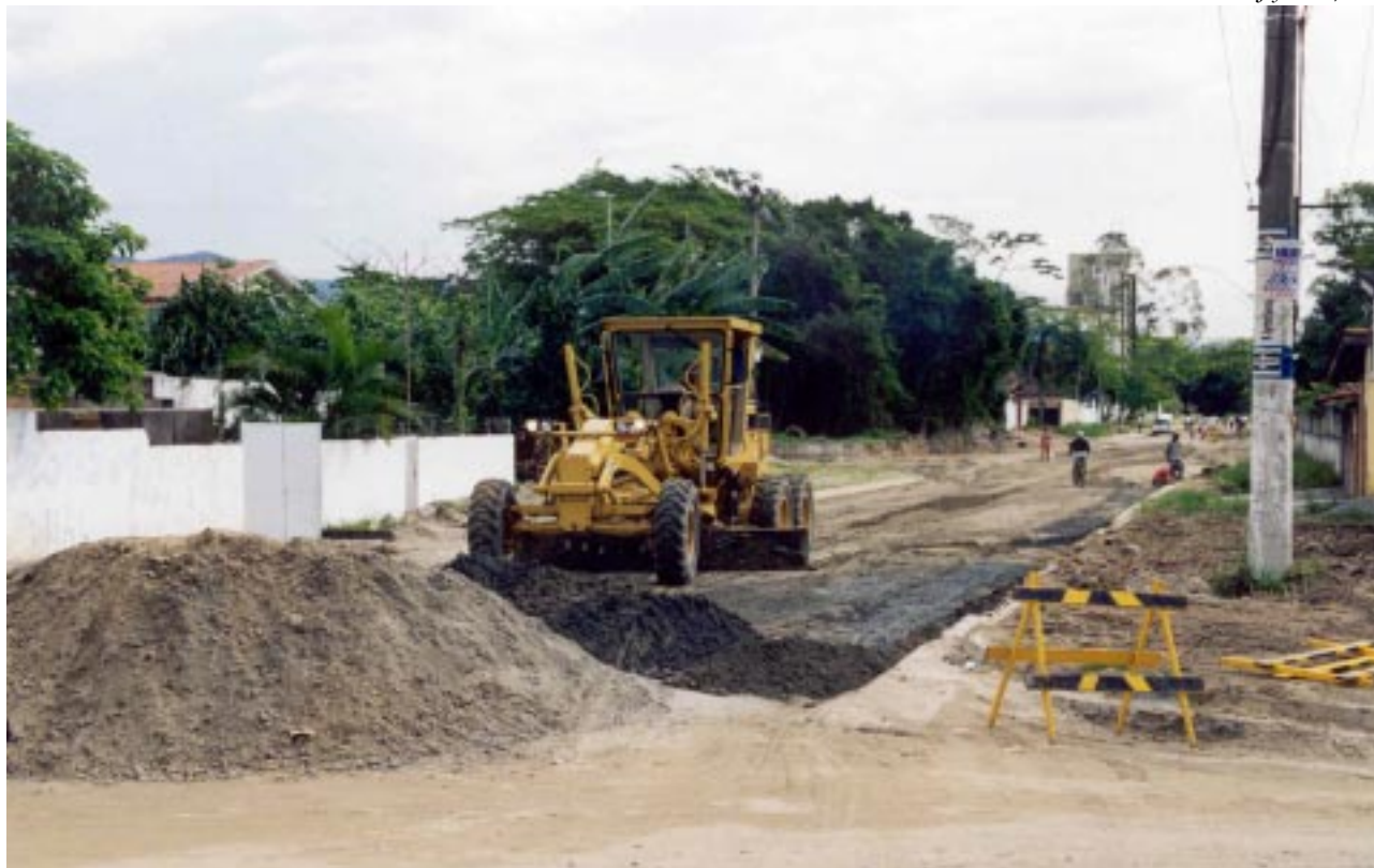
Serviços estão sendo feitos por etapas: primeiro trecho a receber melhorias está situado entre as ruas Manoel Gajo e General Osório
